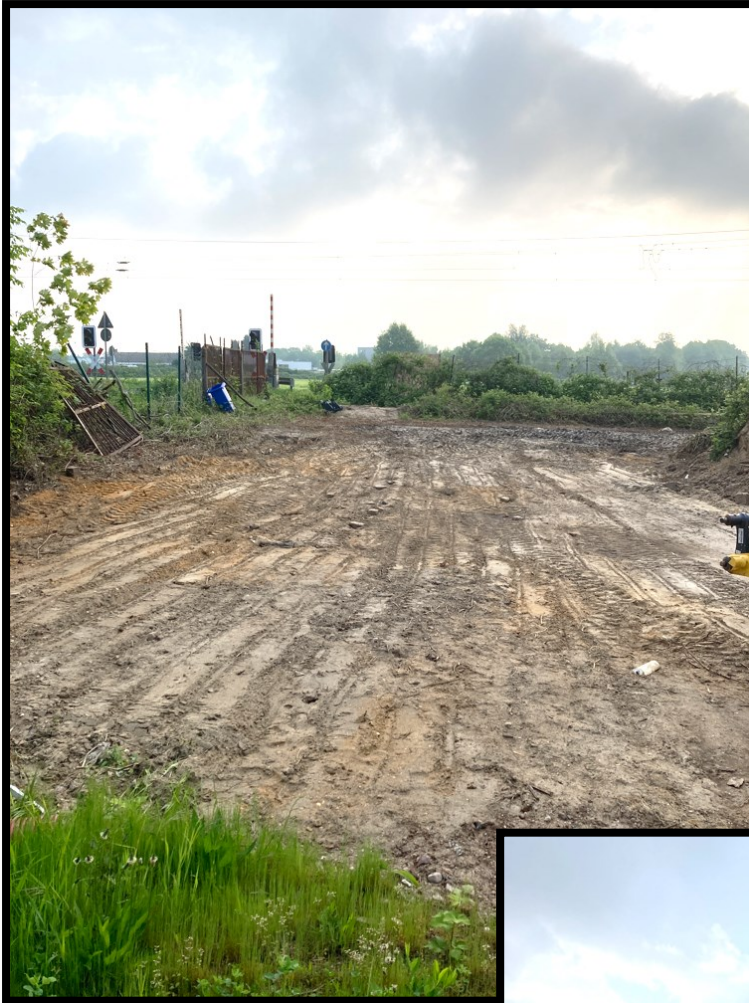
Abb.: aktueller Charakter des Plangebietes an der Nordwestgrenze des nördlichen Teilbereichs – Baustelleneinrichtungsfläche dient der Baumaßnahme der Bahn (Lärmsanierung – siehe ges. Verfahren). Aufnahme datum 5.2023
