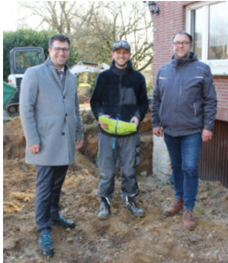
► Foto: Gratulation auf der Baustelle: v.l. Bürgermeister Christian Küsters, Robin und Holger Hannes (BAUSANI)
